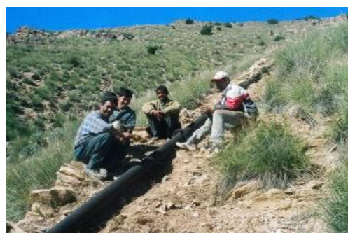
Conduite forcée de la turbine, Ouneine
